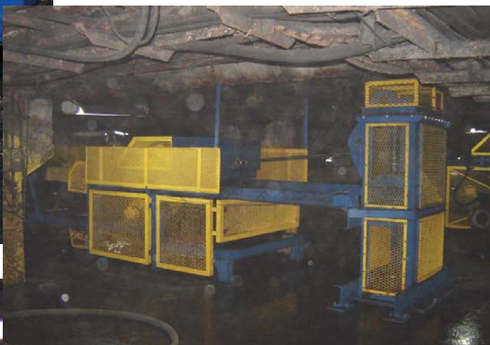
Napęd przenośnika 96 w zakładzie przeróbczym – poziom + 6 m
